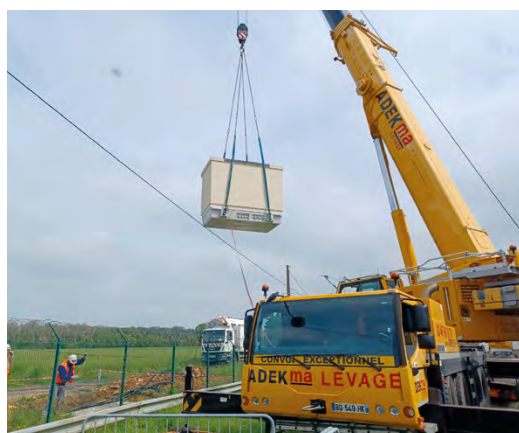
Livraison par le SIEIL d'un nouveau poste de transformation pour une entreprise d'Esves-sur-Indre.
