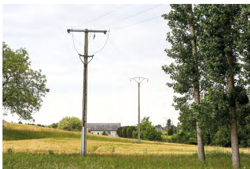
En 2023, le SIEIL a renforcé et sécurisé le réseau électrique de nombreux territoires d'Indre-et-Loire.
