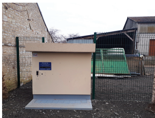
La Tour-Saint-Gelin - Post de transformation au sol simplifié de type A (PSSA)
