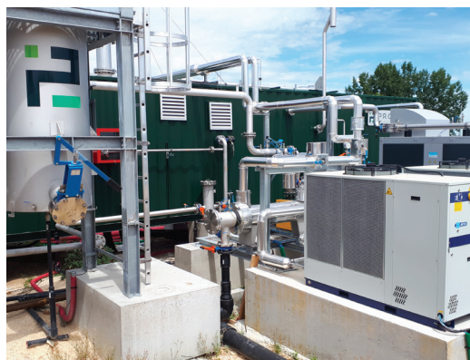
Unité de filtration et de purification de biométhane au Louroux
