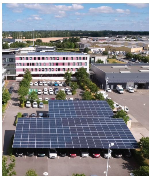
Centrale photovoltaïque en ombrière de parking pour entreprise (100kWc)
