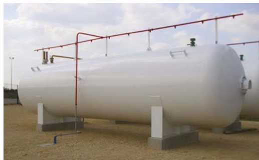
Système d'aspersion automatique. Sécurité incendie citerne 22 tonnes de propane.
