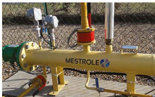
Vaporisateur propane en sortie de réservoir de stockage
