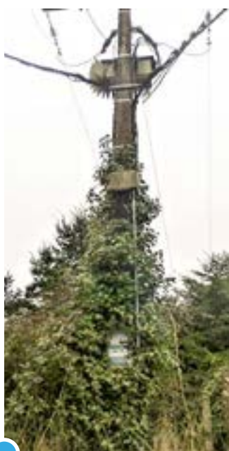
Défaut d'entretien sur un transformateur aérien à Civray de Touraine
