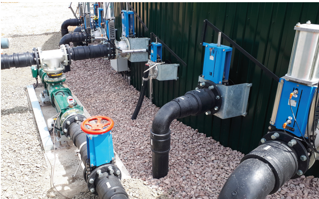
Réseau digesteur unité de méthanisation
