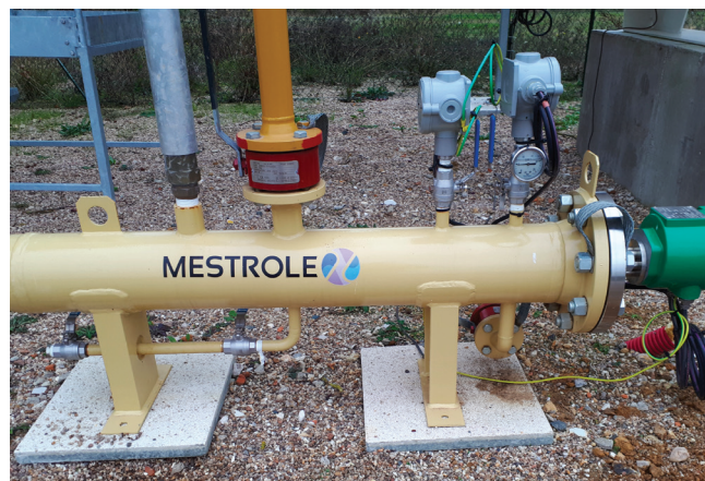
Réchauffeur de propane (sortie citerne)
