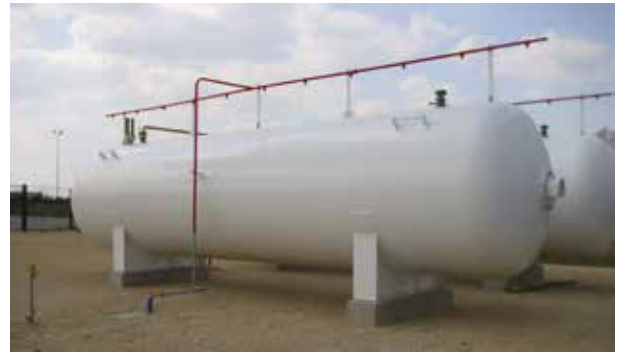
Aspersion automatique citerne 22 tonnes – Site classé ICPE
