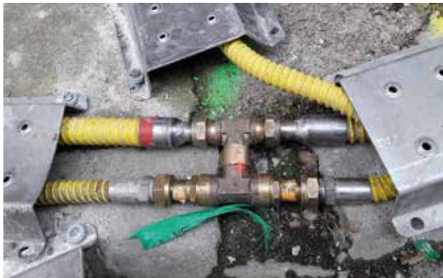
Réseau gaz naturel aérien provisoire
