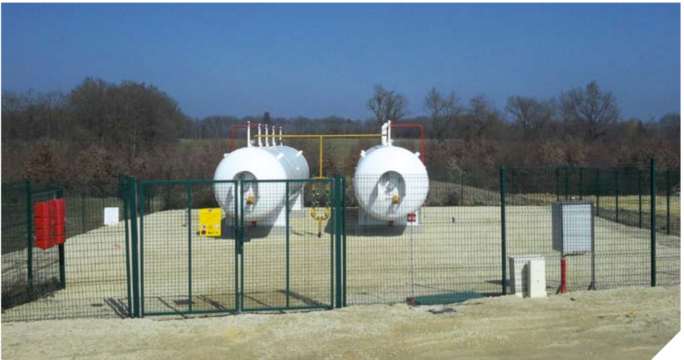
Site de stockage 2 x 22 tonnes - Azay-le-Rideau / La Loge
