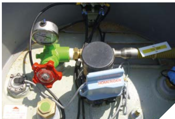
Appareillage citerne enterrée
