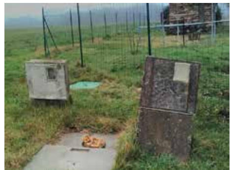
Nouzilly Coffrets endommagés 29 mai 2017
