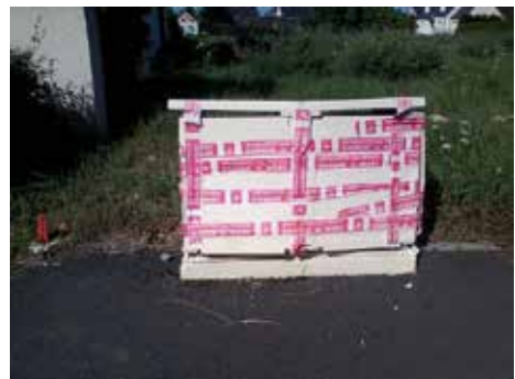
Fondettes Coffret endommagé 17 juillet 2017
