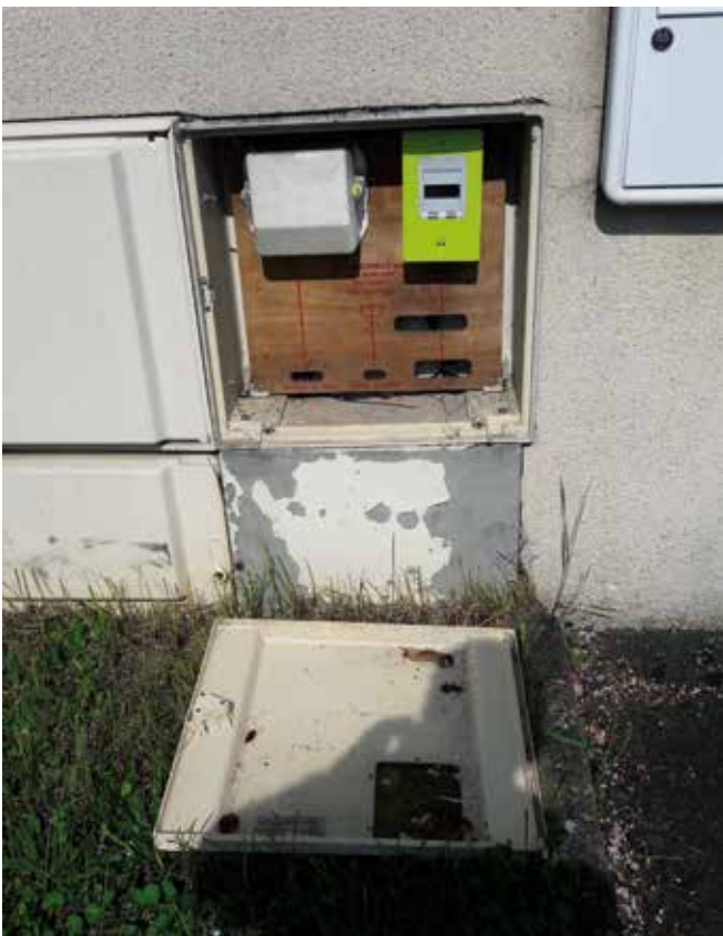
Notre Dame d'Oe Coffret endommagé 25 mars 2017
