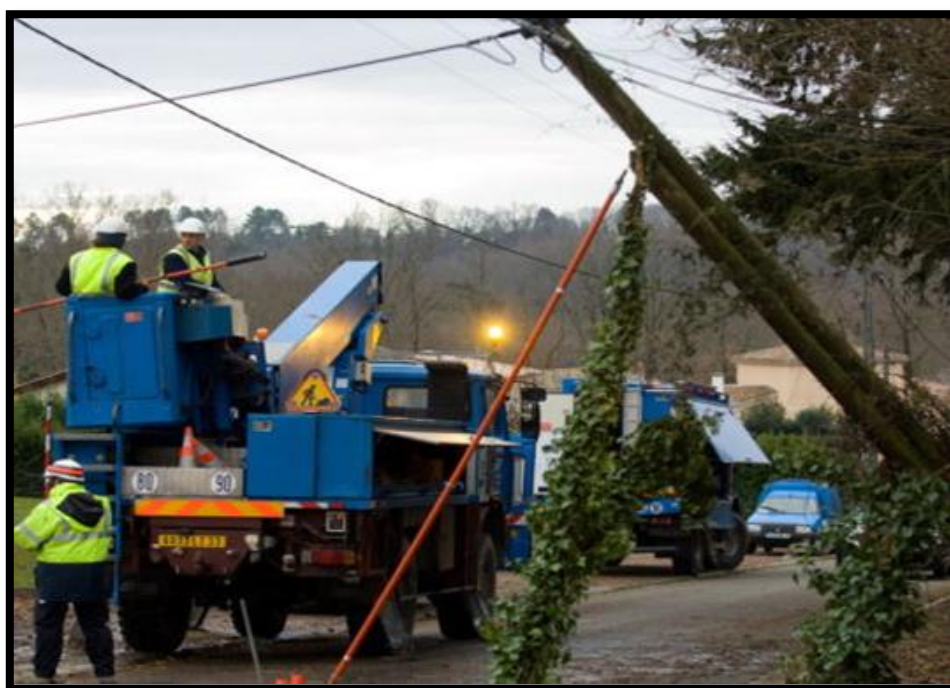
Photo 1 – Pylône électrique endommagé suite au passage de Xynthia en Indre-et-Loire (ERDF, 2010)
